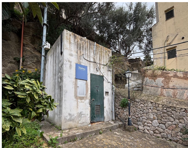
Central de telecomunicacions situada al barri de s'Arraval
